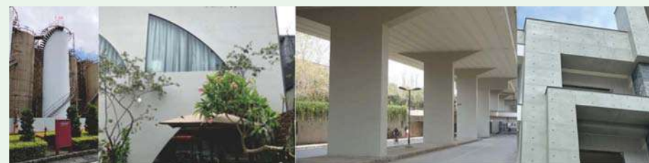
化學儲槽槽身
