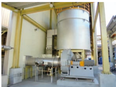
廢氣焚化爐更改為旋轉蓄熱式焚化爐
