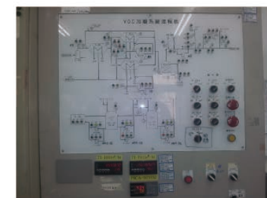
深冷回收設備自動監控儀錶
