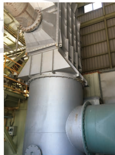
廢氣處理設備 鈉鹽爐
