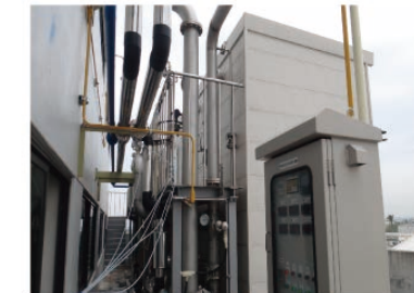
生物濾床防制設備
