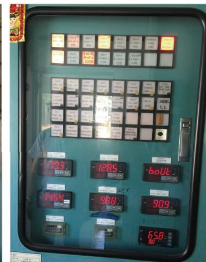
廢氣處理設備 鈉鹽爐自動監控儀錶
