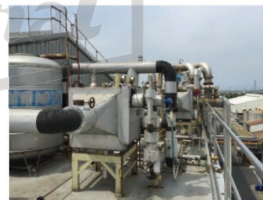
深冷回收設備
