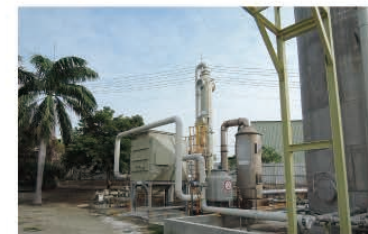
廢氣處理設備 水洗塔
