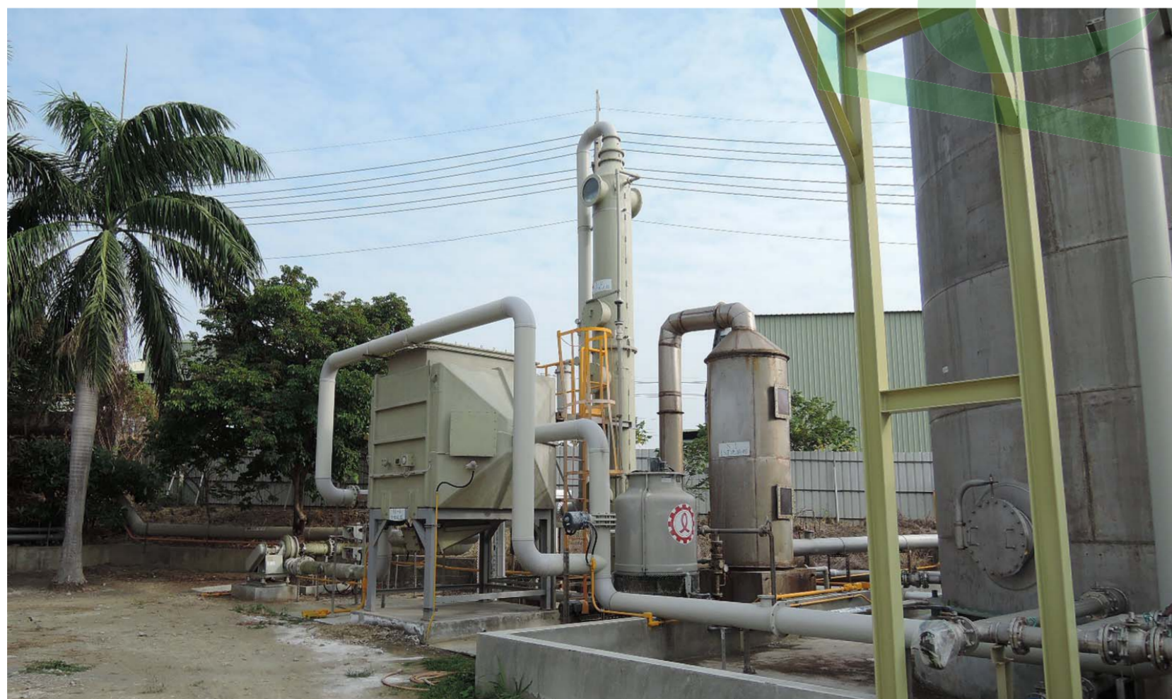
廢氣處理設備 - 水洗塔
