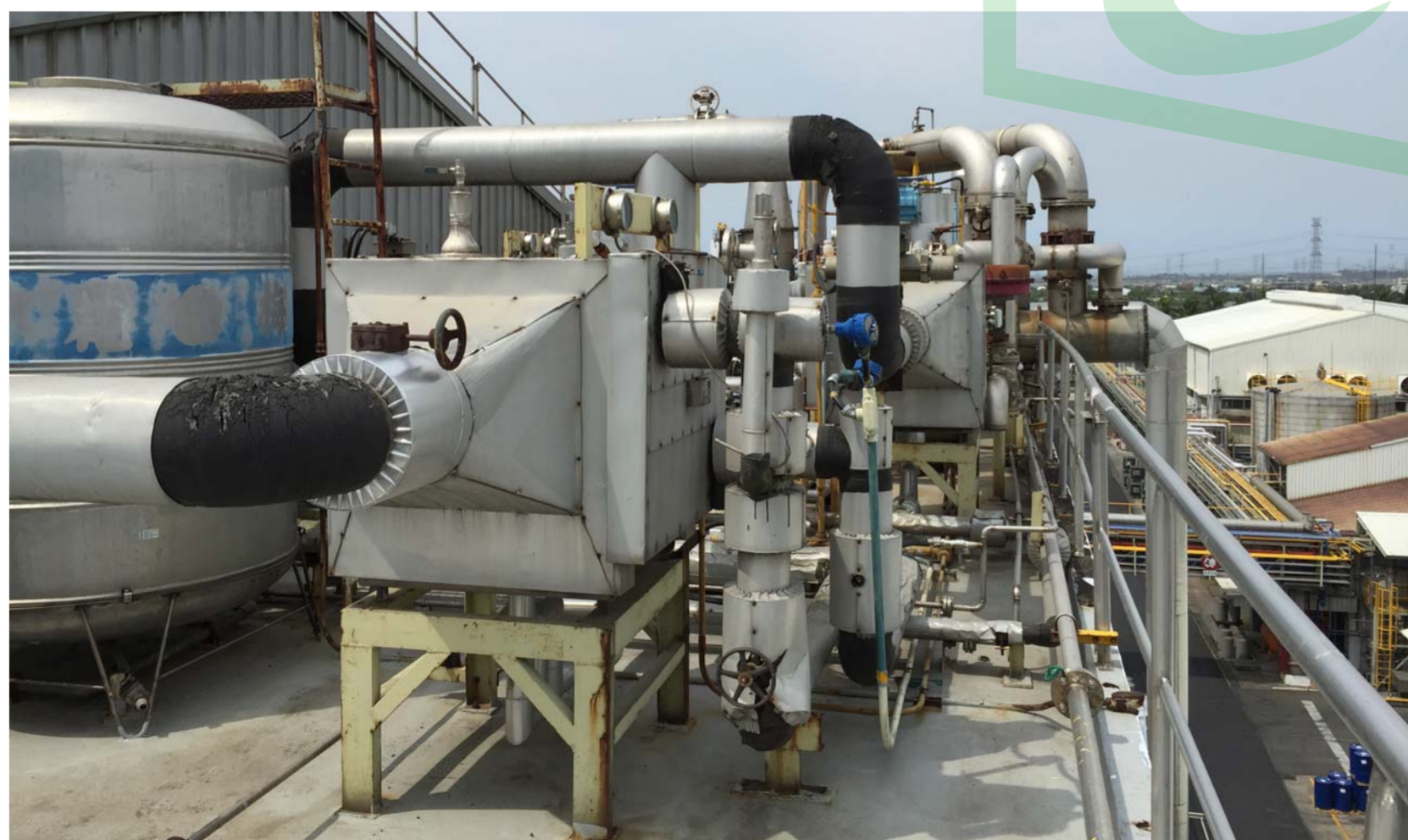
廢氣深冷回收設備
