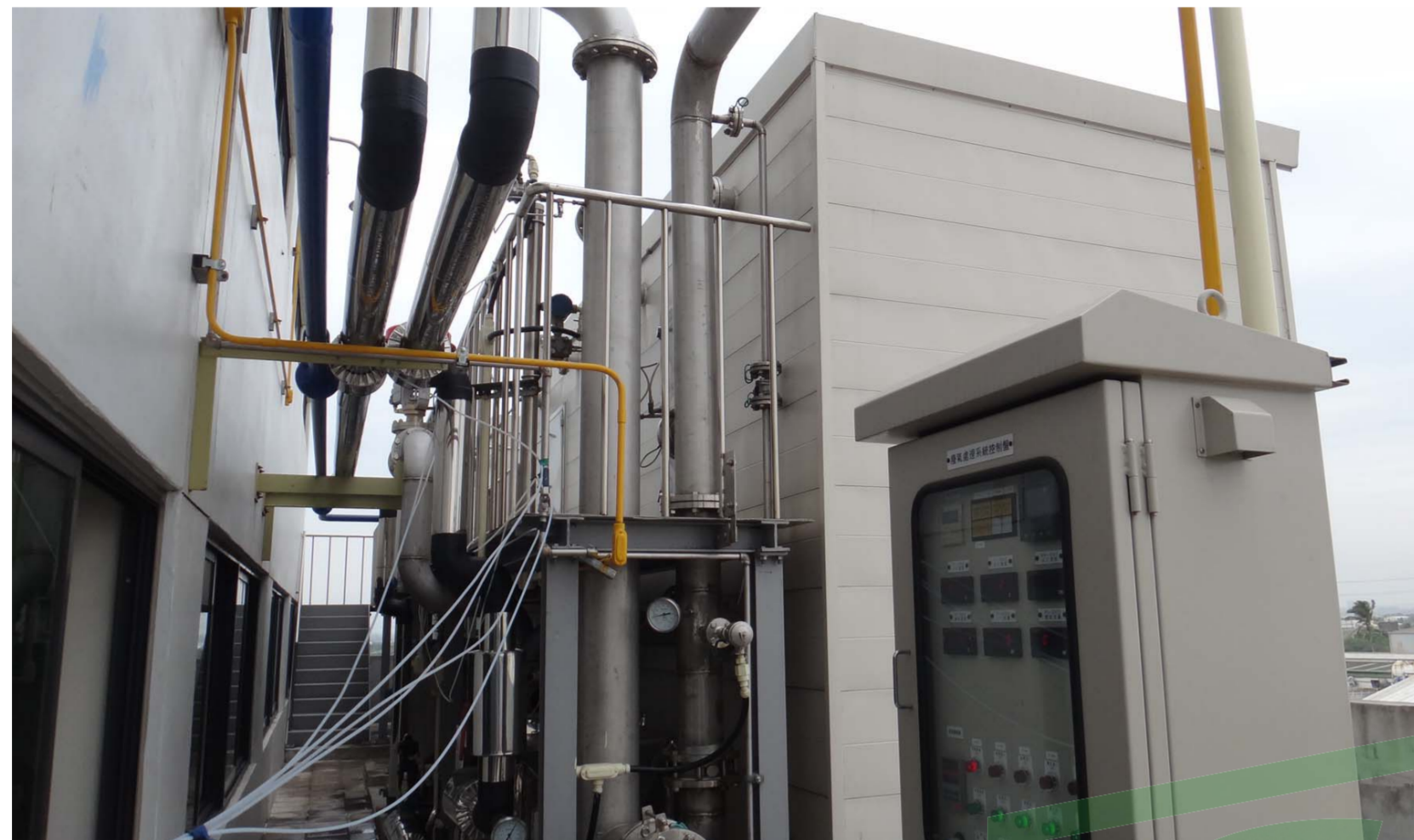
生物濾床防制設備
