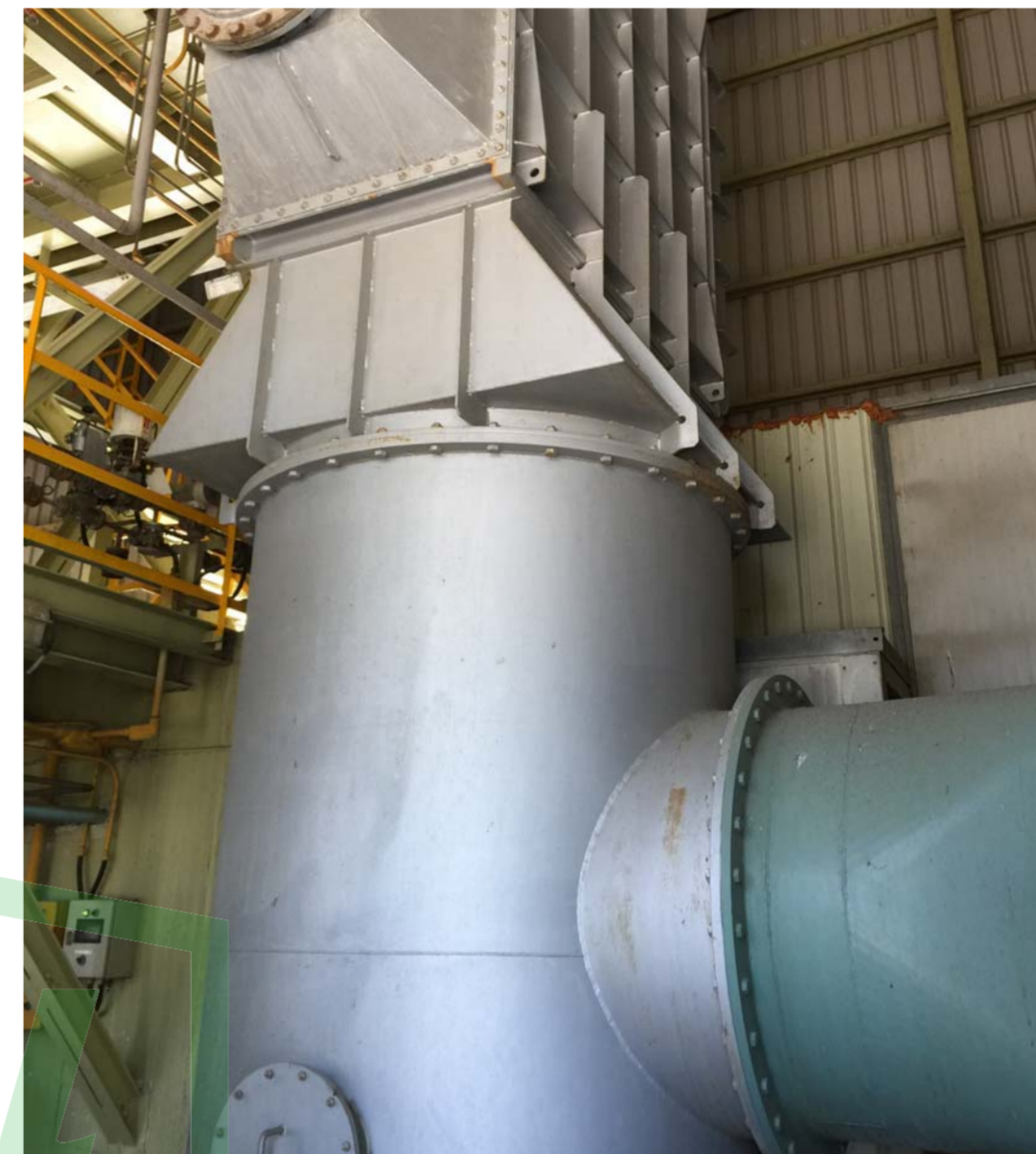
廢氣處理設備 - 鈉鹽爐
