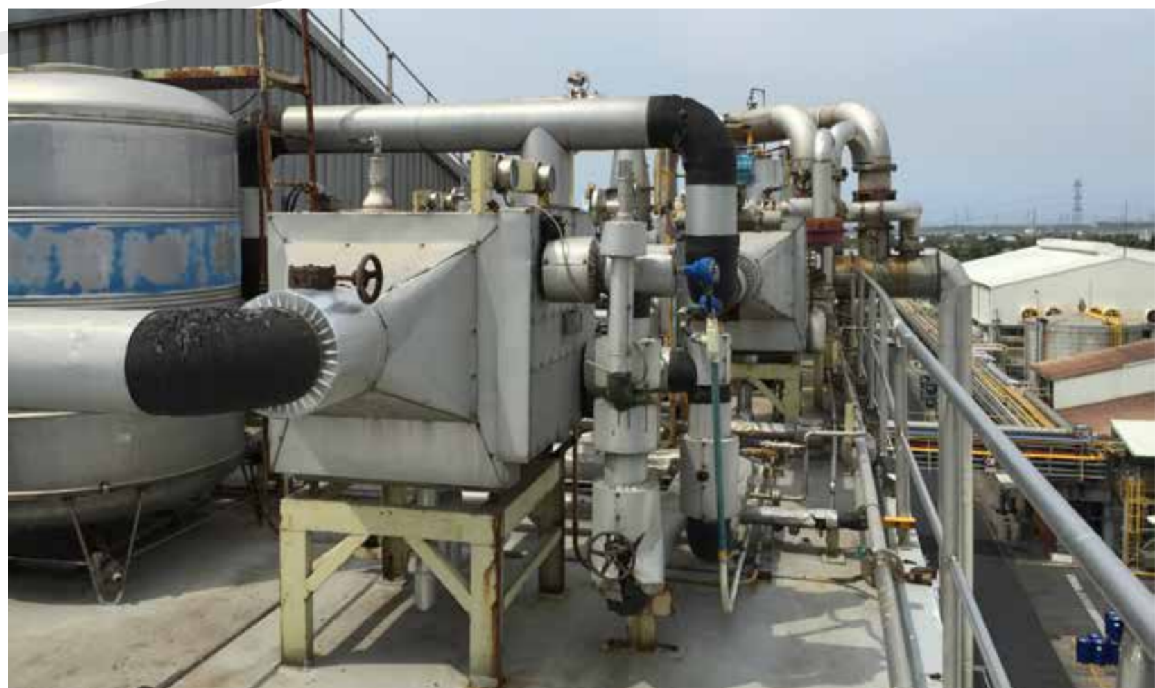
廢氣深冷回收設備
