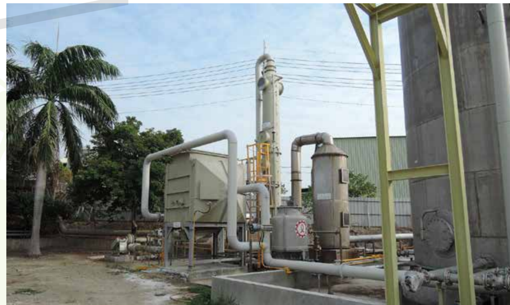
廢氣處理設備 - 水洗塔
