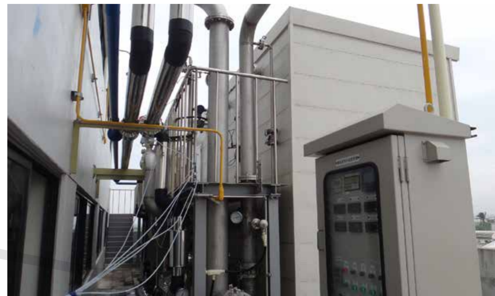
生物濾床防制設備
