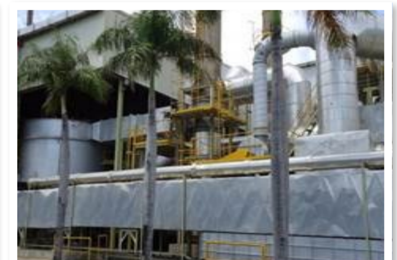
▲ 廢氣焚化爐防制設備
