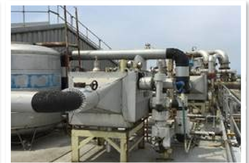
▲ 深冷回收設備
